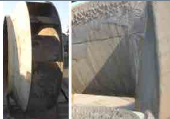
Build-up on fan blades
